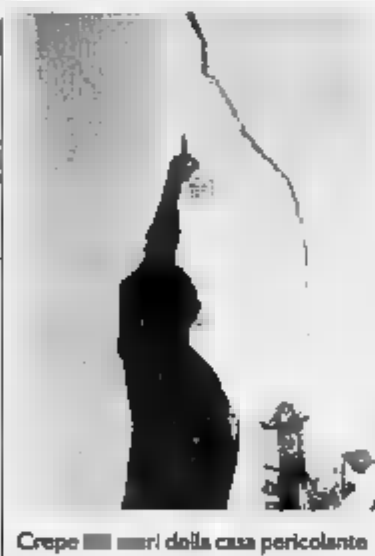
Crepe nei muri della casa pericolante
